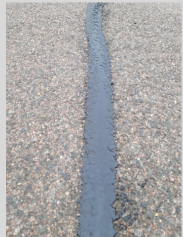
Trhlina zalitá asfaltovou zálivkou s překrytem
