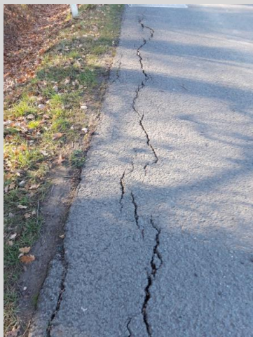
Trhliny v asfaltu před ošetřením
