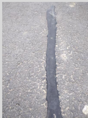
Trhlina zalitá asfaltovou zálivkou bez překrytu
