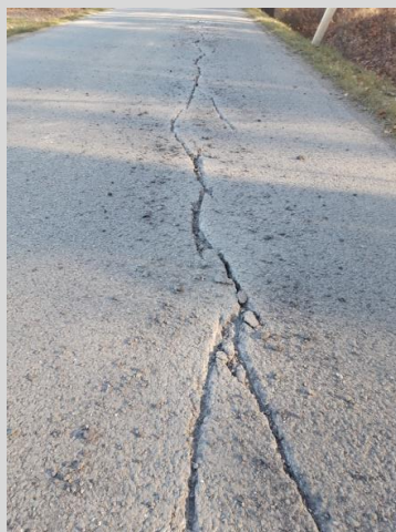
Trhliny po vyfrézování
